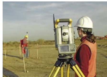
Replanteo y carreteras: replanteo automatizado de proyectos sencillos o complejos.
